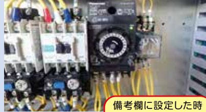
既設タイマー設定変更後
