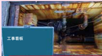
(工事前) 既設機器設置状況
