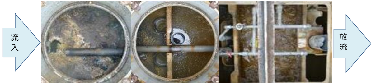
①嫌気ろ床槽1室 ②嫌気ろ床槽2室 ③生物ろ過槽 ④処理水槽及び消毒槽
