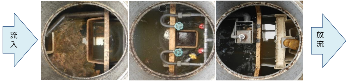
①嫌気ろ床槽1室 ②嫌気ろ床槽2室 ③接触ばっ気槽 ④沈殿槽及び消毒槽
